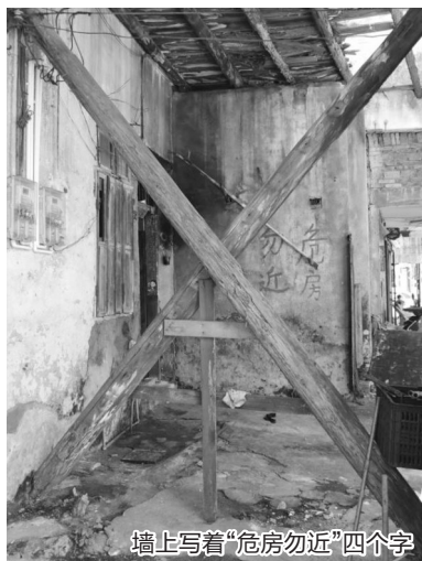
木板严重腐蚀
