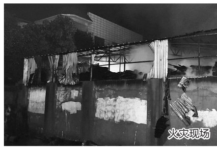
22时05分,消防官兵确认现场无复燃情况后,才撤离。目前,起火原因正在调查中。
